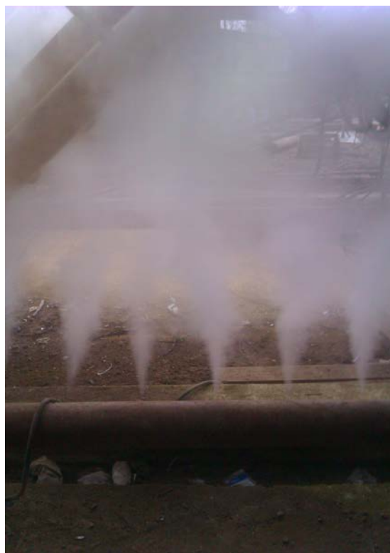
Рис.3. Истечение водяного пара из перфорированного трубопровода при защите печного агрегата.
